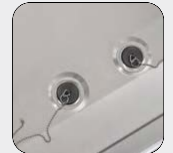
Abflusslöcher mit Ablaufventil, Stöpsel und Kette
